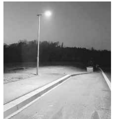
Bushaltestelle mit Solar-Straßenlampe im Betrieb
